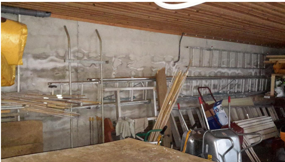
står mye fukt i kjeller
