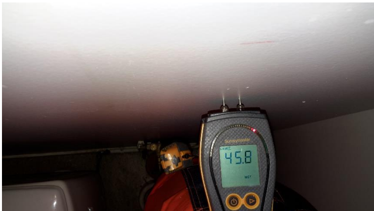
Fukt i vegg toalett 1,5m fra gulv
