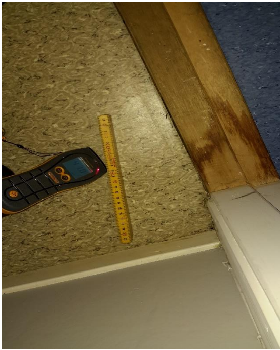
Fukt i gulv toalett
