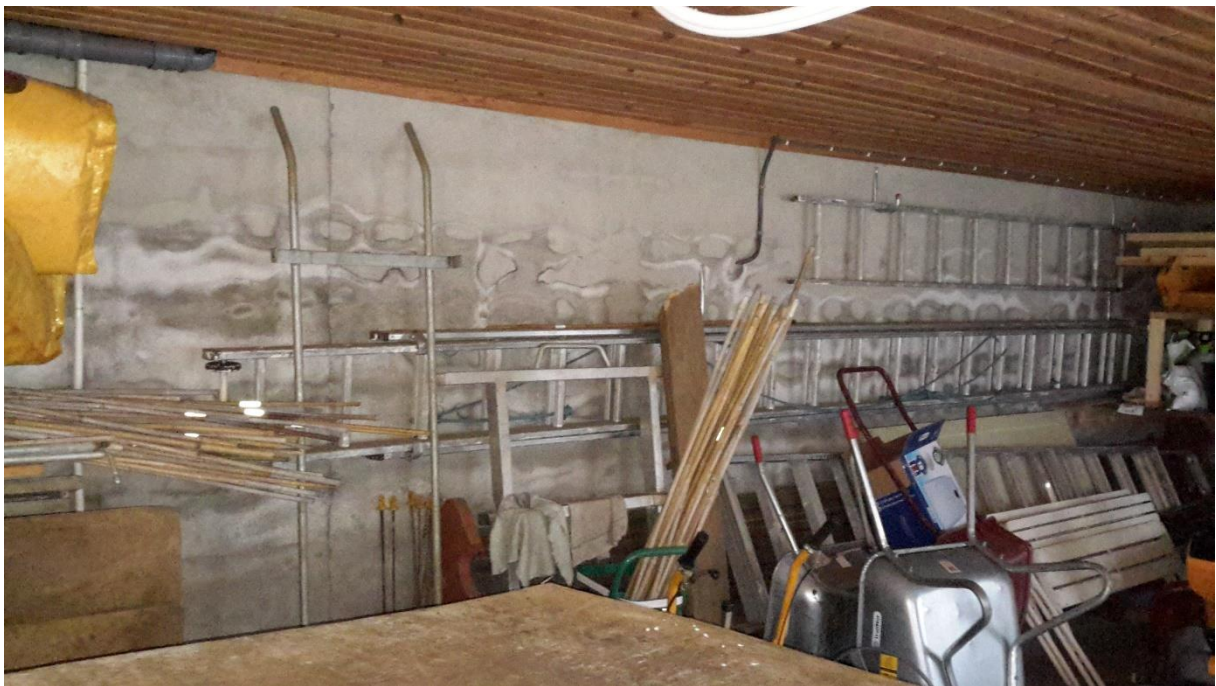
står mye fukt i kjeller
