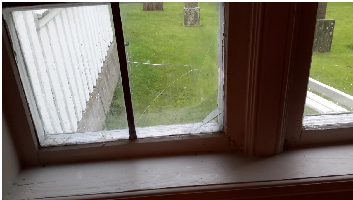
En del sprekker i vindu
