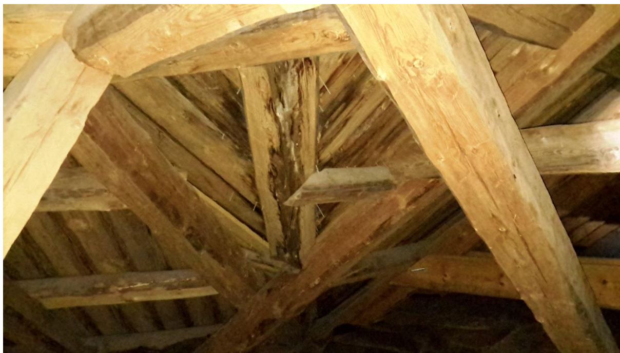
Gammel taklekkasje, var tørt under inspeksjon. Tak utbedret når??
