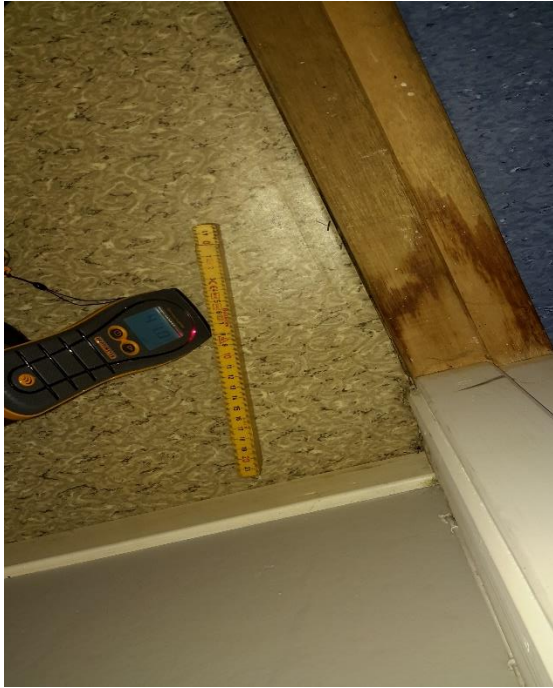
Fukt i gulv toalett
