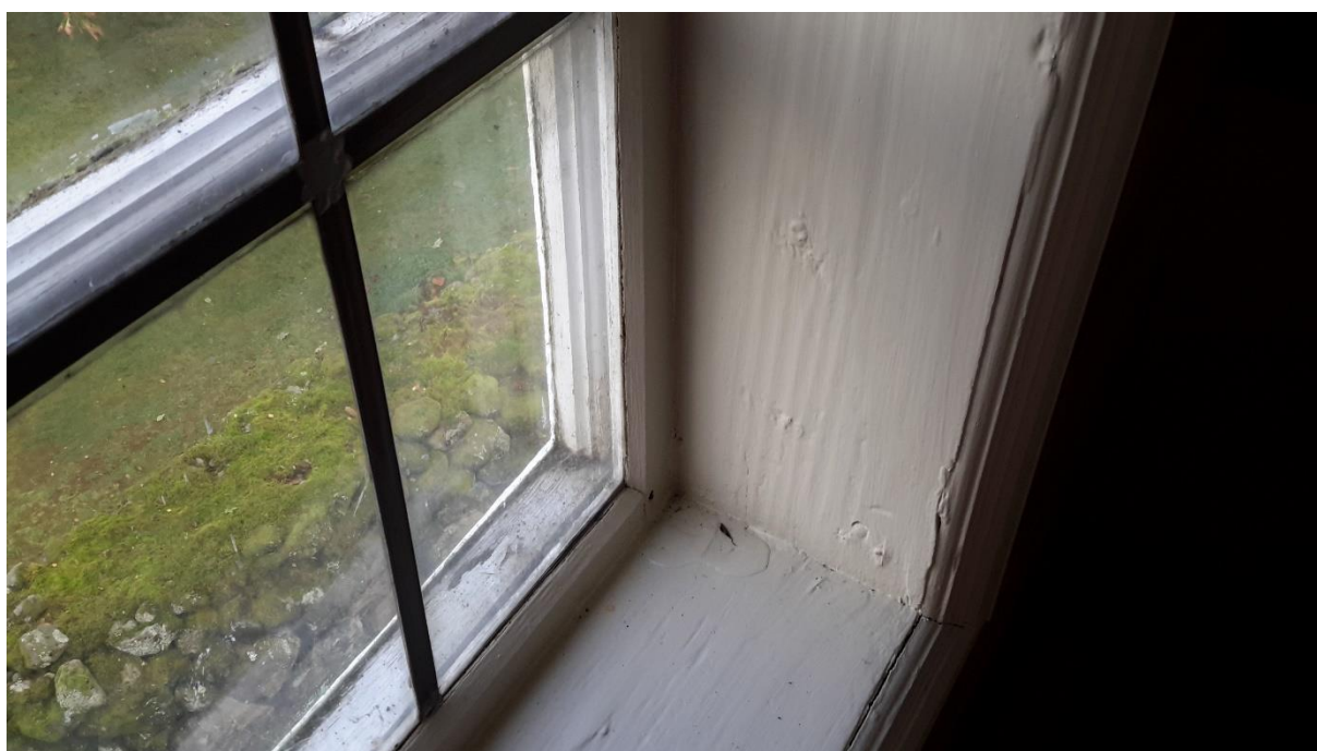
Vann kommer inn gjennom sprukket vindu bak orgel
